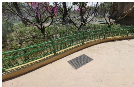
主题园区污水排水井
